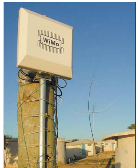
Bild 2: WLAN-Access-Point an einem Pfahl im QTH2
